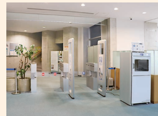
エントランス (内側) / 除菌機
